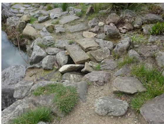
Рис. 12 Разрушенный каменный мостик в нижней части ручья
